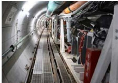
「トンネル掘進完了後の放水トンネルの様子 ©東京電力」 https://www.jaif.or.jp/journal/japan/17716.html
